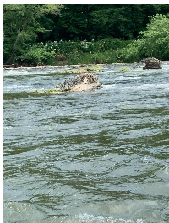
東恵橋旧橋脚 鉄筋の露出
